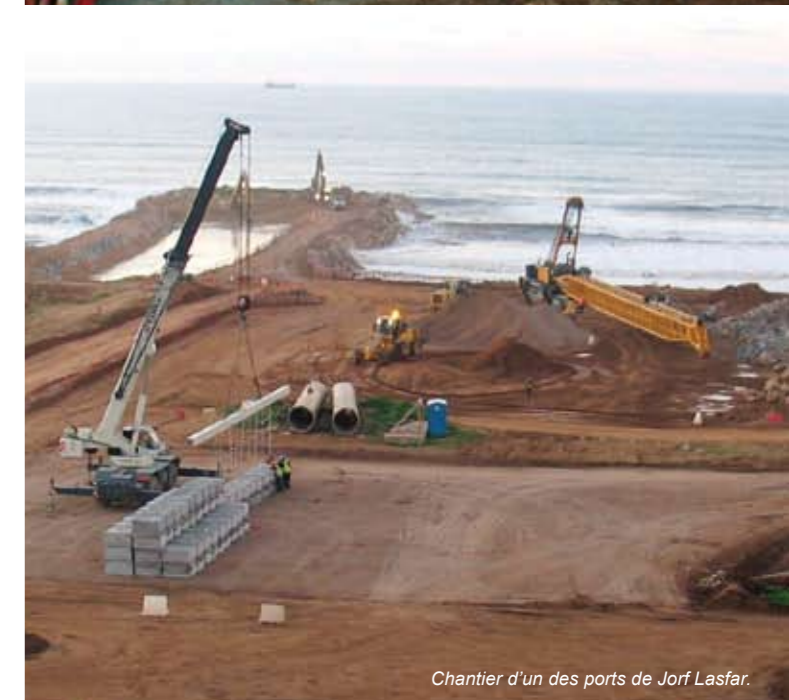
Bassin d'arrivée du pipeline Khouribga-Jorf Lasfar.
